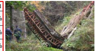
香川・徳島県境 無名橋(鋼2径間単純トラス橋) の落橋(2007年)
