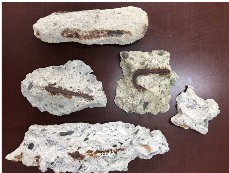
写真 3-1 コンクリート破片
