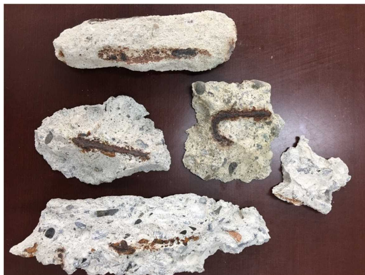
写真 3-1 コンクリート破片
