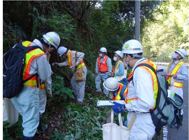
自然斜面，落石，切土，擁壁の点検と診断，補修 (東川町・県道 317，湯山柳・一般県道湯山北条線)
