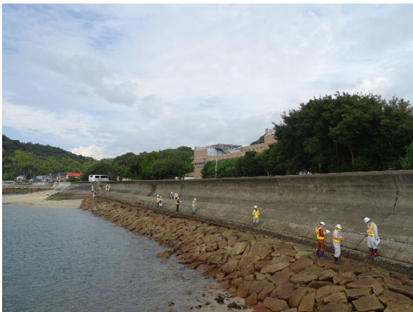
海岸施設の点検と診断，補修（立岩海岸）
