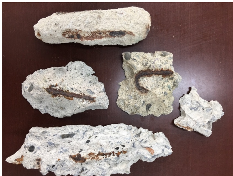
写真 3-1 コンクリート破片
