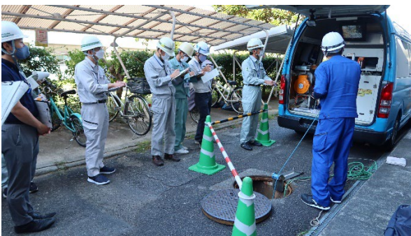
下水道（愛大構内）
